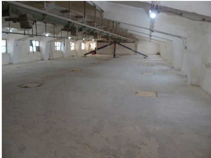
Obrázok č.2 Existujúci stav nad skladovacími silami
